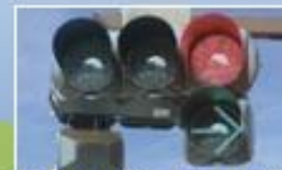
交通信号システム装置
